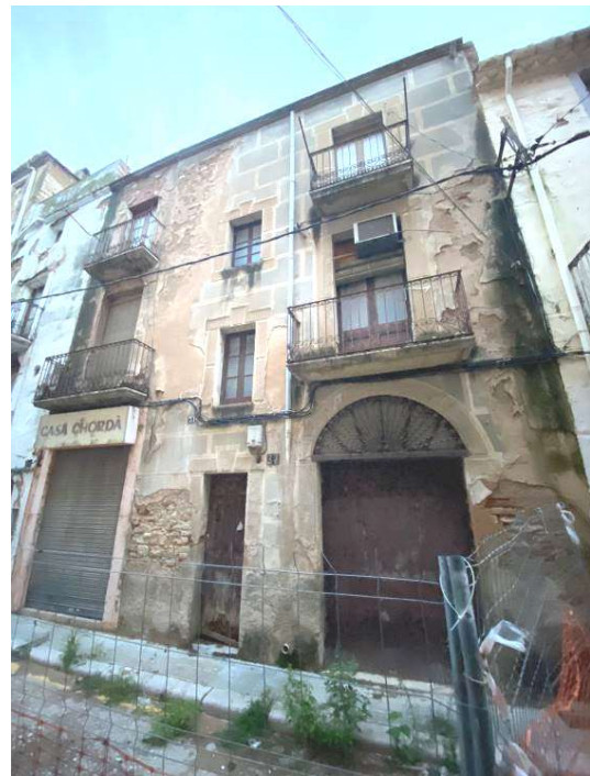
Carrer Sant Antoni 37, edifici en mal estat aparent
