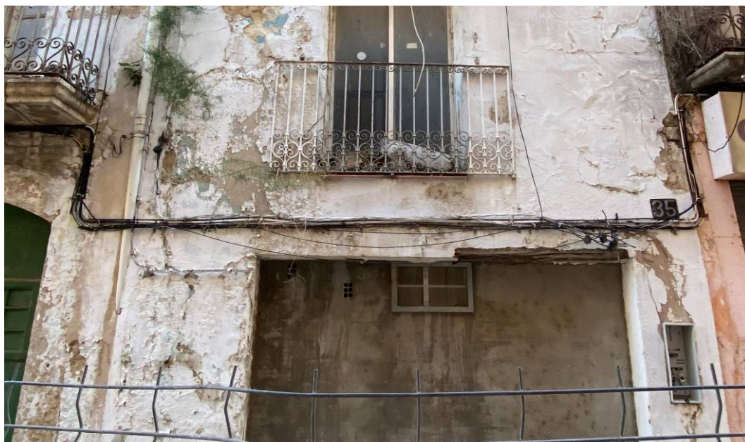
Estesa aèria grapada en façana ; quadre elèctric eliminat
