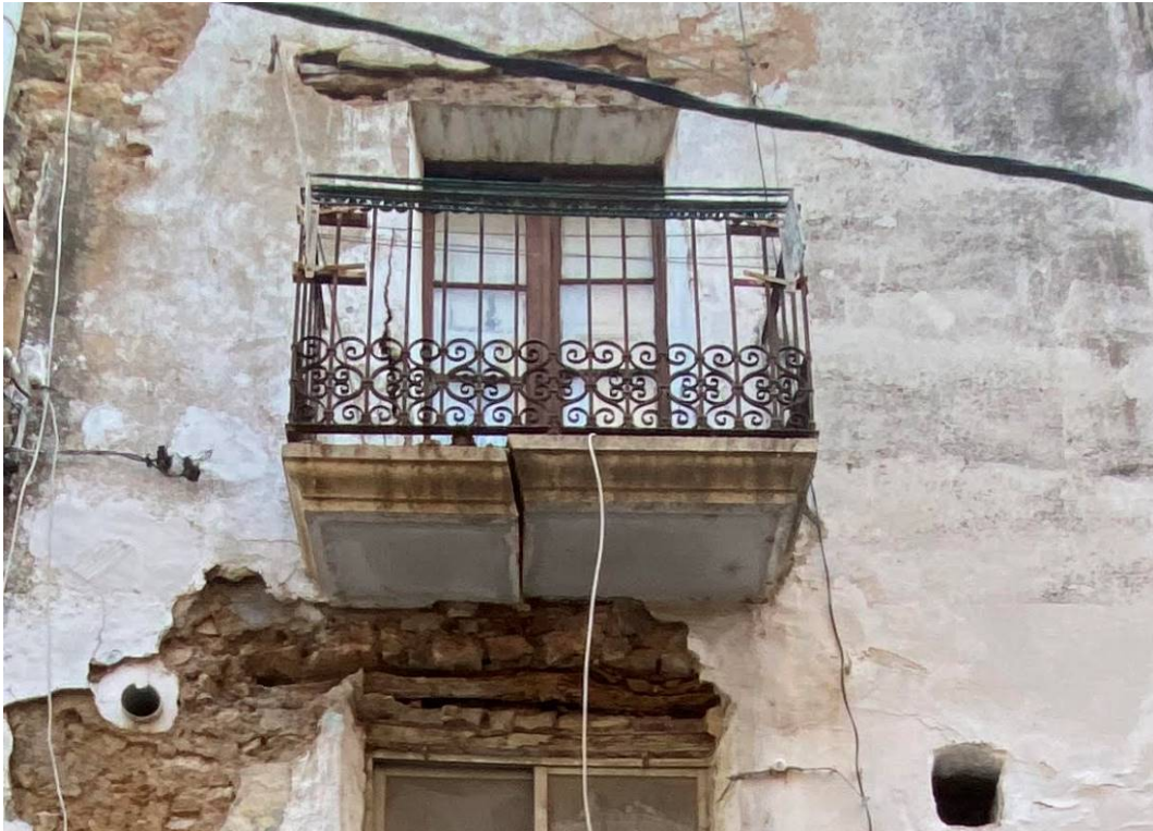
Llosa de balcó en estat precari ; les llindes també present un estat de conservació incert
