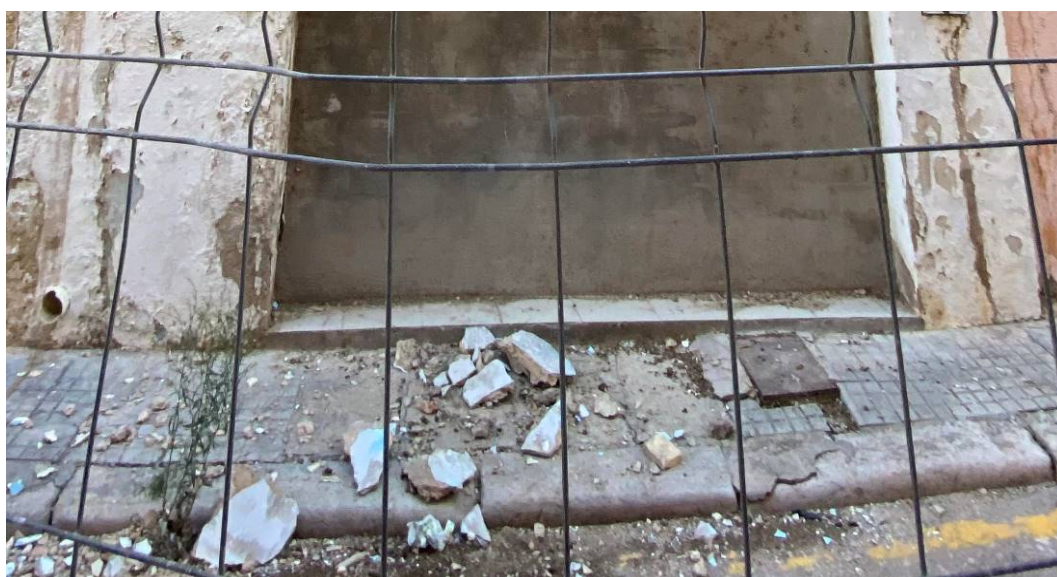
Vista despreniment revestiment façana sobre la vorera
