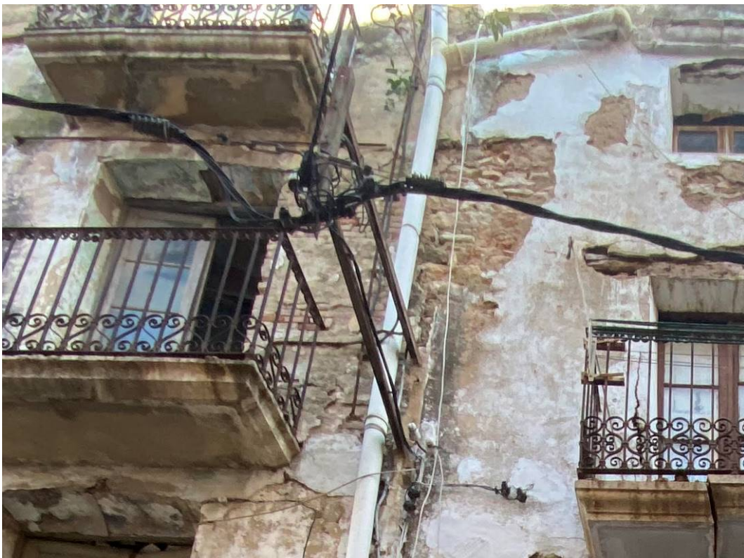
Palometa elèctrica a protegir i/o desplaçar sobre un pal vertical clavat a la vorera
